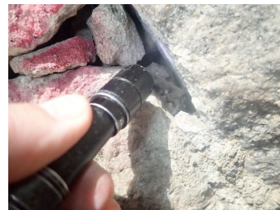
写真-2 空石積擁壁背後の空洞化
