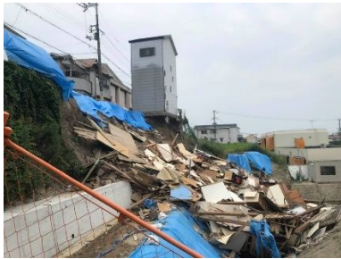
写真-1 空石積擁壁の崩壊（大阪市西成区天下茶屋東2丁目）
